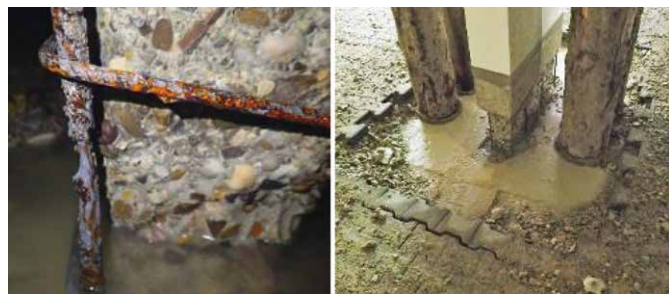
Bild 2 Bewehrungskorrosion und Instandsetzungsmaßnahme an einem Stützenfuß infolge Chlorideinwirkung
