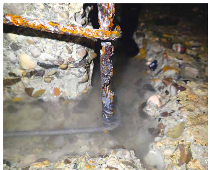
Bild 1 Bewehrungskorrosion an einem Stützenfuß infolge Chlorideinwirkung
